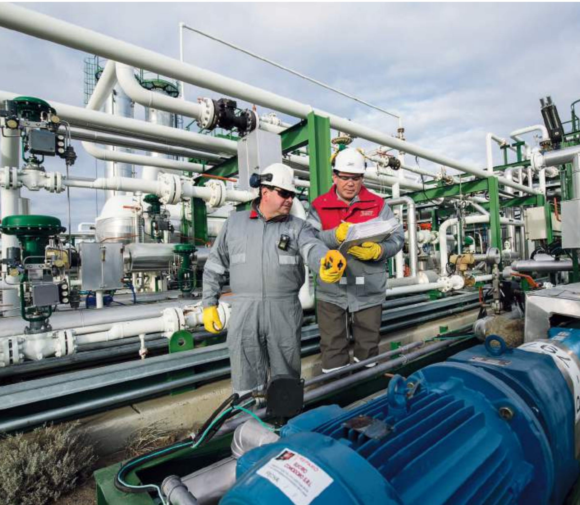
Control de equipamientos de la Planta de Tratamiento de Gas Fase VI.
