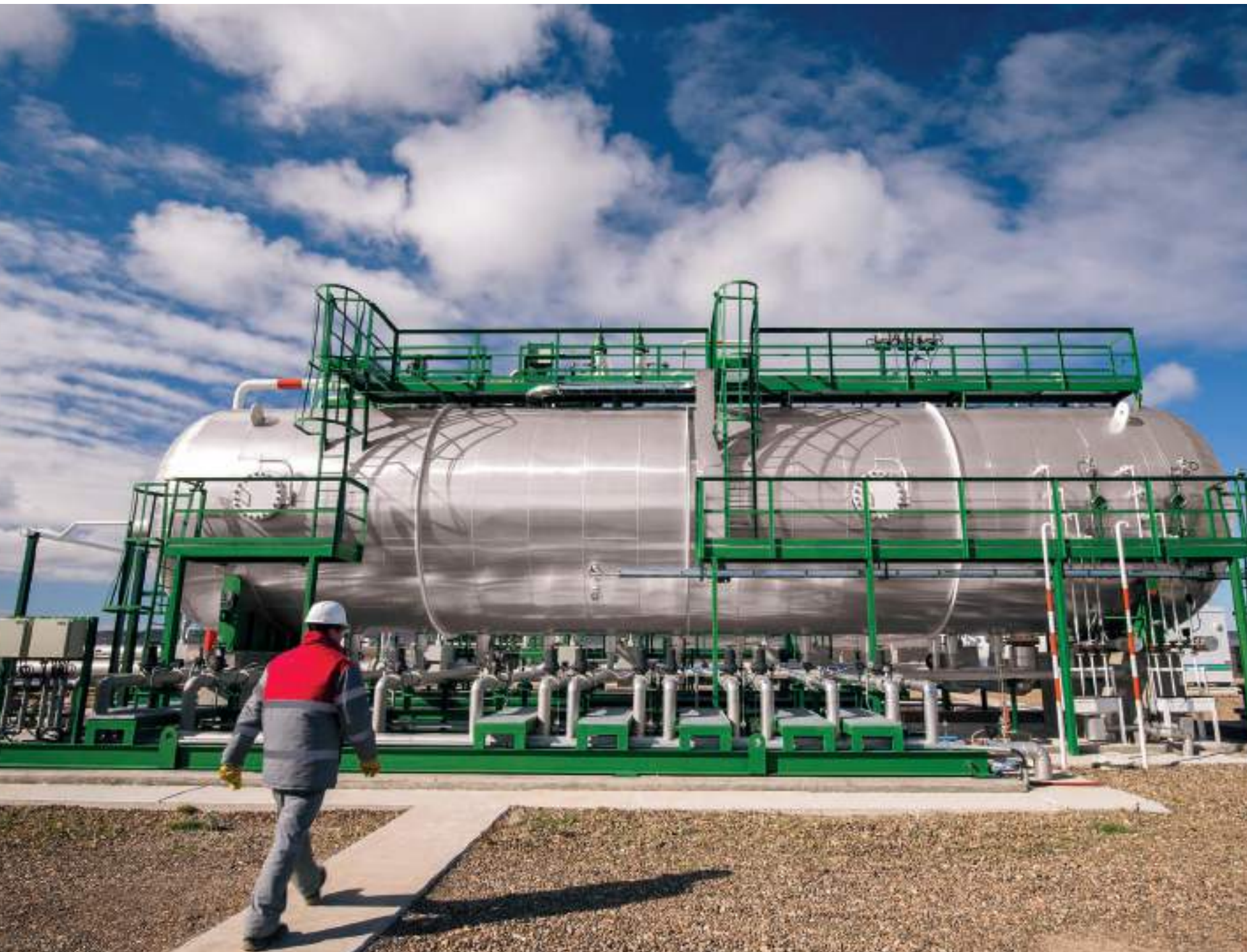
Las baterías efectúan la separación primaria del petróleo, el gas y el agua de formación extraídos del subsuelo.
