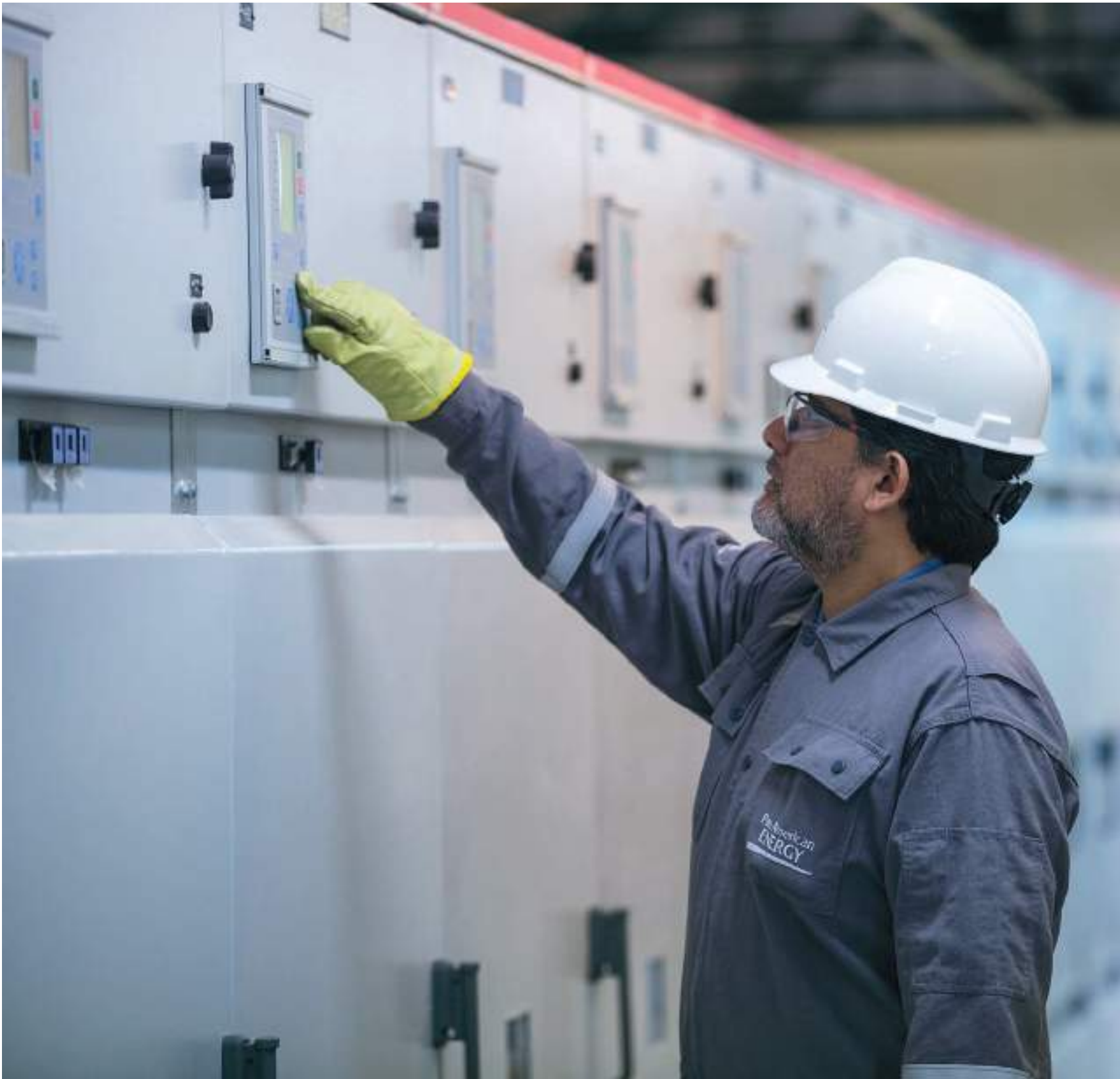
Sala de celdas de 33 kilovoltios en la estación de transformación de la usina Cerro Dragón.
